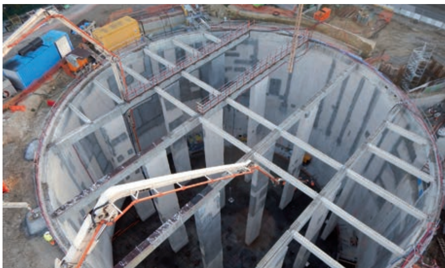
Un bassin du même type (ci-dessus à Issy-les-Moulineaux) sera construit sous le stade Emile-Gagneux.
